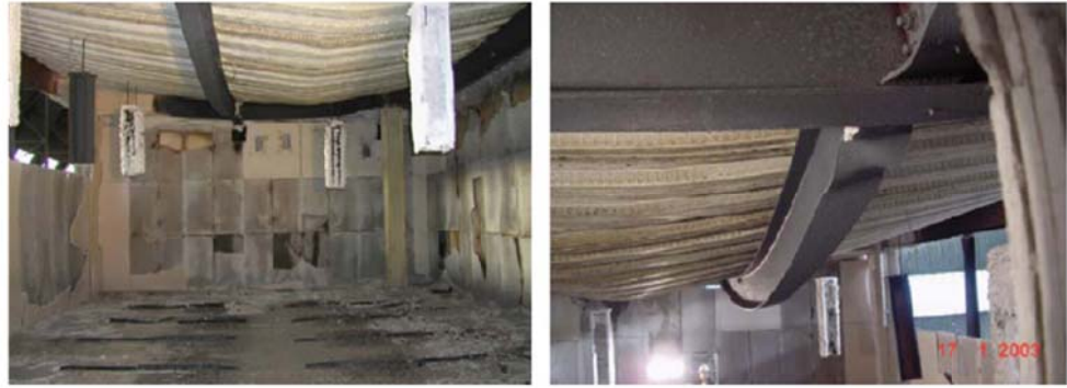
Figure 2.25 Vue du plancher après l'incendie
