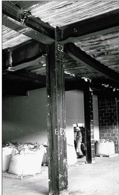
Figure 2.10 Vue de la structure après le test
