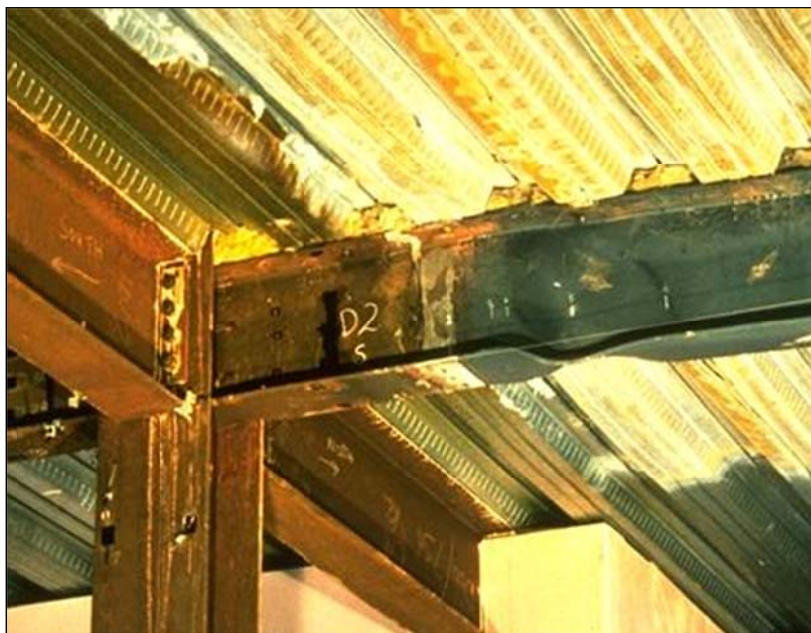
Figure 2.5 Voilement de la semelle de la poutre restreinte
