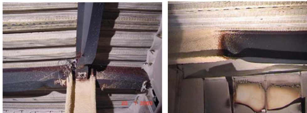
Figure 2.26 Plusieurs poutres métalliques déformées
