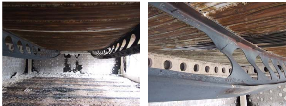
Figure 7.53 Flèche de la dalle/poutre non protégée après le feu
