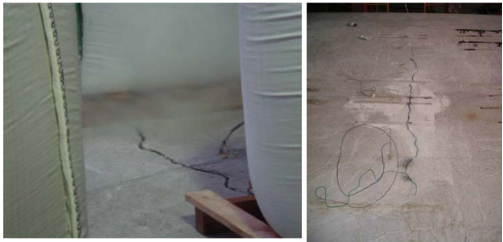
(a) Etat de la fissure en partie centrale de la dalle
