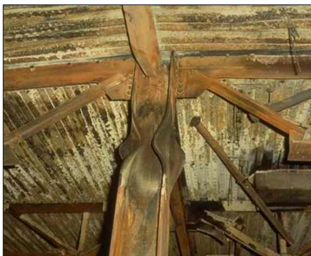
Figure 4.1 Colonne voilée et poutres déformées dans le Broadgate
