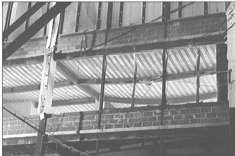
Figure 2.14 Structure déformée pendant l'incendie
