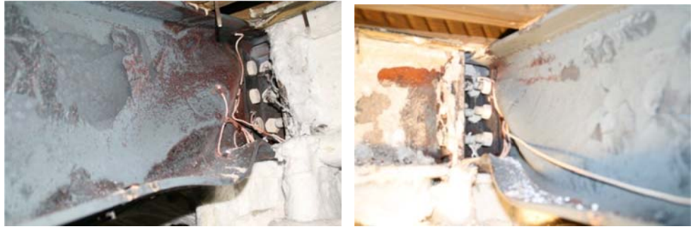
Figure 7.39 Voilement local des poutres secondaires non protégées assemblées aux colonnes
