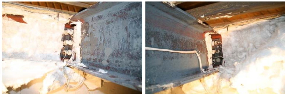
Figure 7.40 Pas de voilement local des poutres secondaires non protégées assemblées aux poutres principales
