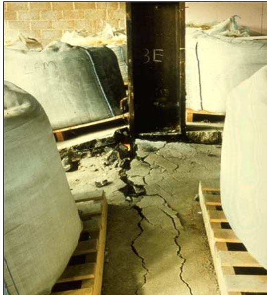
Figure 2.21 Dalle fissurée à proximité du non recouvrement des grillages d'armatures
