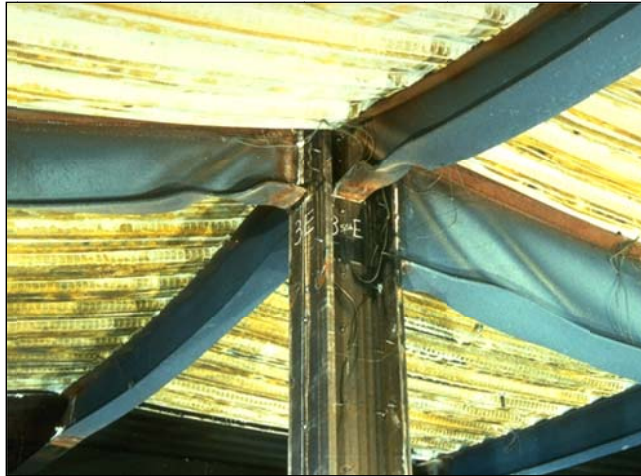
Figure 2.20 Tête de colonne montrant le voilement des poutres
