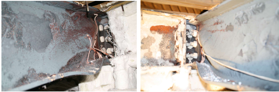
Figuur 7.39 Plooiën van onbeschermden kinderbalken verbonden aan een kolom
