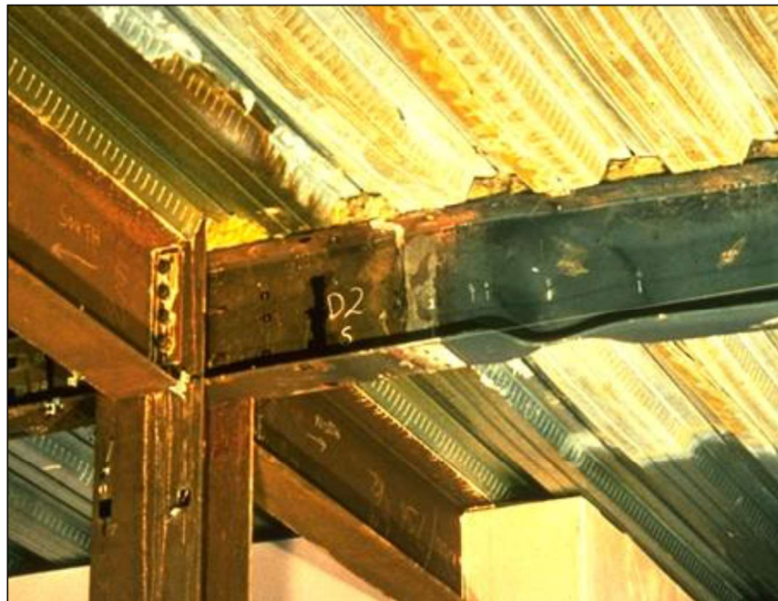
Figuur 2.5 Plooiën van de flens in de opgesloten ligger
