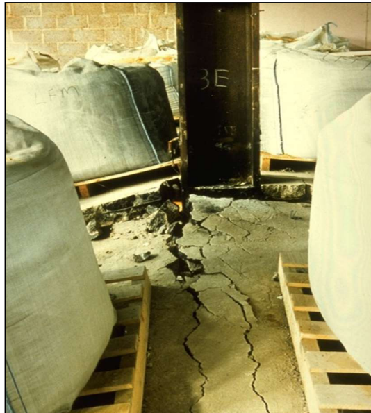
Figuur 2.21 Gecheurde vloerplaat in het gebied waar het wapeningsnet niet overlapte
