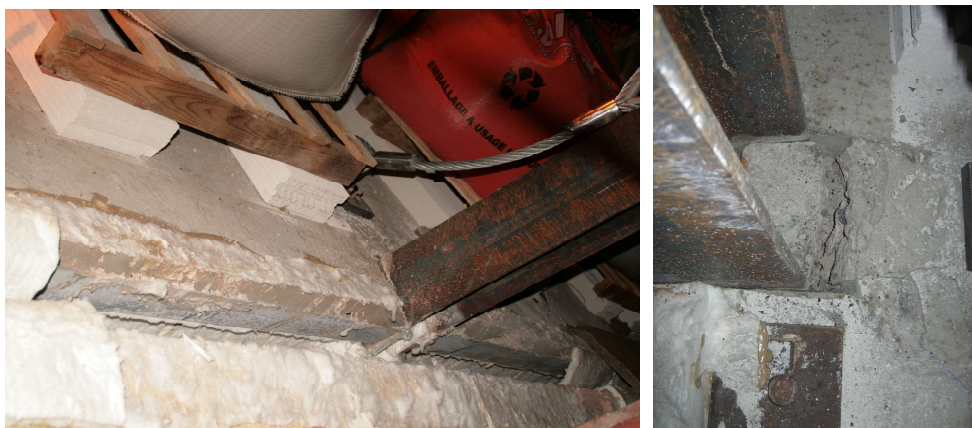
Figuur 7.42 Scheurvorming van beton rondom de centrale kolommen
