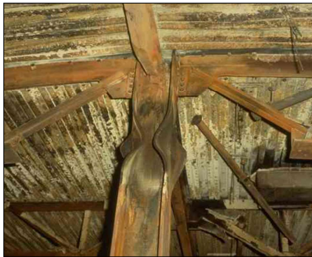
Figuur 4.1 Geplooide kolom en vervormde liggers in Broadgate
