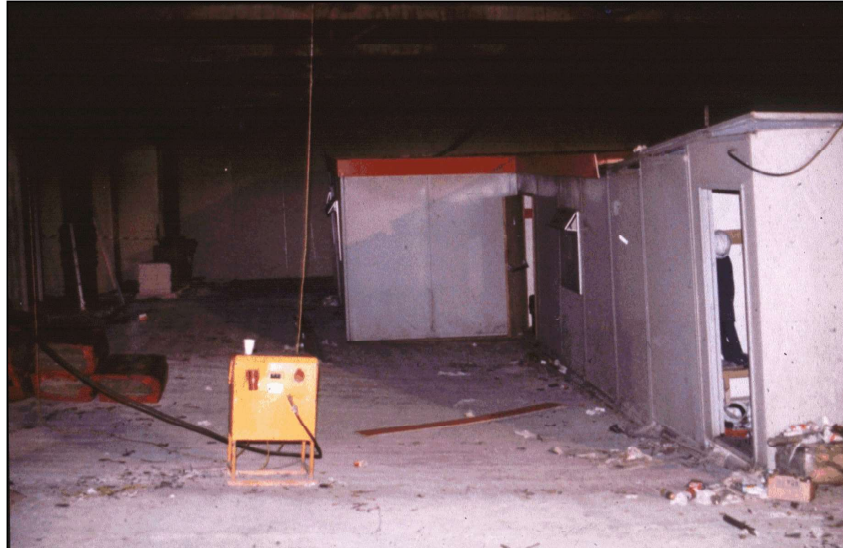
Figuur 4.2 Aanzicht van de vervormde vloer boven de brand (de maximum doorbuiging was ongeveer 600 mm)
