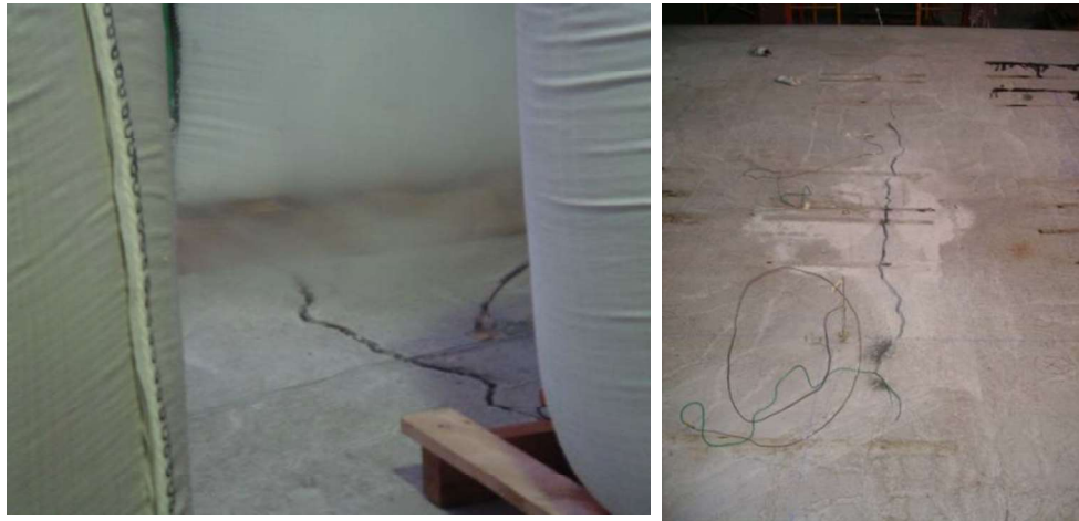
(a) Status van de scheurvorming bij centrale deel van de vloer (b) Status van de scheurvorming na afkoeling
