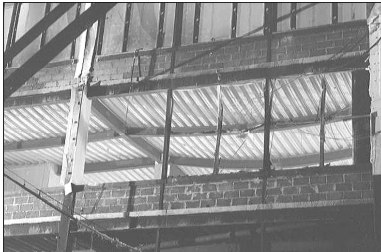
Figuur 2.14 Vervormde constructie gedurende de brand
