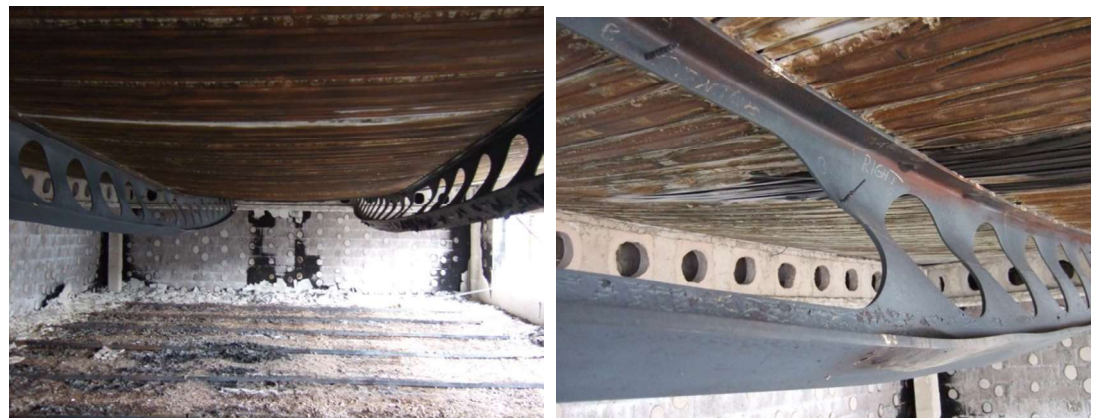
Figuur 7.53 : Doorbuiging van de plaat en de onbeschermd liggers na de brand.
