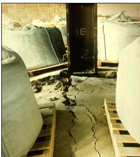
Σχήμα 2.21 Πλάκα που έχει υποστεί θραύση σε περιοχή μη επαρκούς αγκυρωμένου πλέγματος
