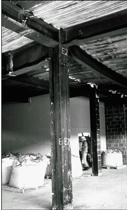
Σχήμα 2.10 Όψη της κατασκευής μετά από το πείραμα
