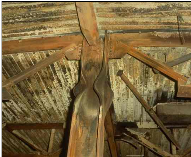
Σχήμα 4.1 Λυγισμένος στύλος και παραμορφωμένες δοκοί στο Broadgate
