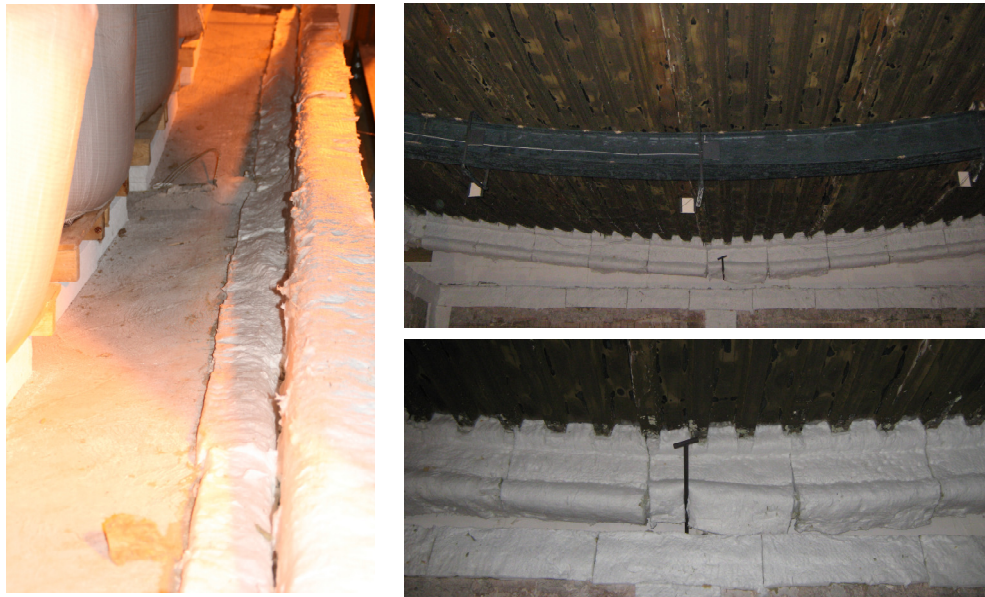
Σχήμα 7.37 Κατάρρευση της ακραίας δοκού
