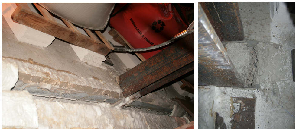
Σχήμα 7.42 Σχηματισμός ρωγμών στο σκυρόδεμα γύρω από τους
