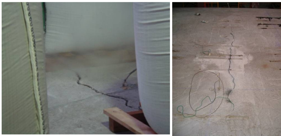
(a) Η ρωγμή στο κεντρικό τμήμα της πλάκας
