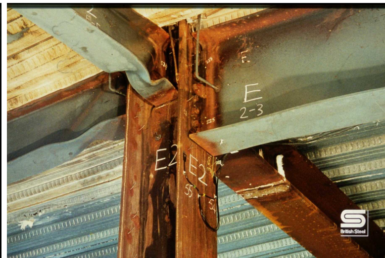
Estado deformado de los elementos de acero alrededor de la columna de acero protegida
