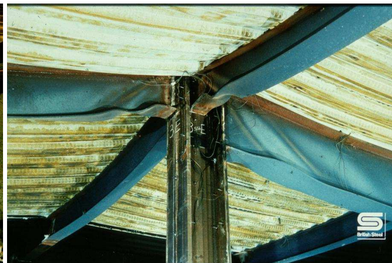
Estado deformado de los elementos de acero alrededor de la columna de acero protegida
